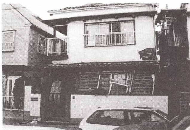
写真 1-4 筋違が対で配置されているが、接合法が不十分
