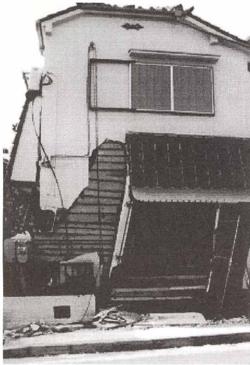
写真 1-7 有効な筋違がない
